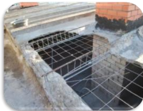
Bojāta jumta konstrukcija
